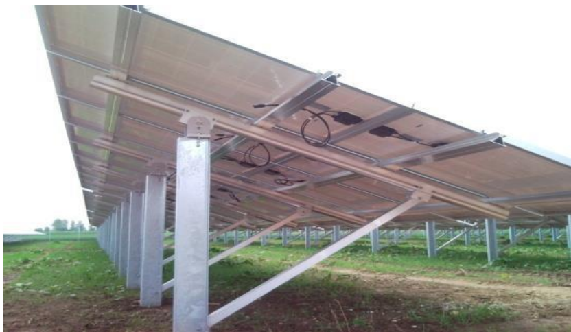
2.14-rasm. Bir o‘qli treker quyosh elektrik stansiyasi.
