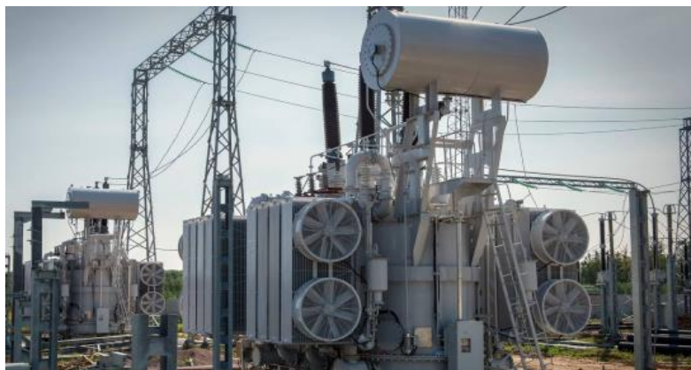
3-rasm. Transformator podstansiyasi.
