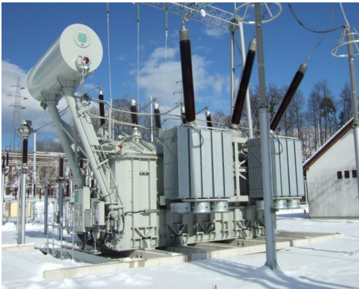
50-rasm. Kuch transformatorlarining umumiy ko‘rinishi.
